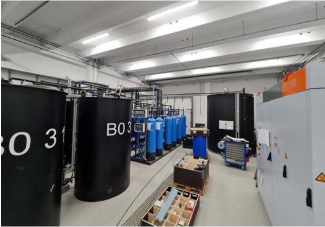
Eine sehr effiziente Aufbereitungsanlage nach dem neuesten Stand der Technik wird am neuen Standort für optimale Wasserqualität sorgen.
